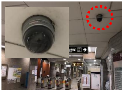
駅構内防犯カメラ
