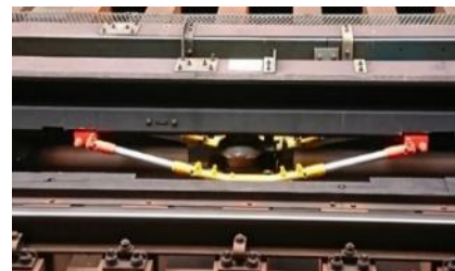
サードレール(集電部分) 脱落防止装置
